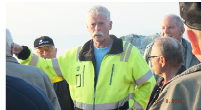
Brudd- og sprengningsleder Gaute Guddal forteller om ting man må tenke på før man skal sprengre. Det er viktig å bore riktig antall hull i rett mønster og bruke rett mengde sprengstoff for å få minst mulig finstoff etter sprengningen.
